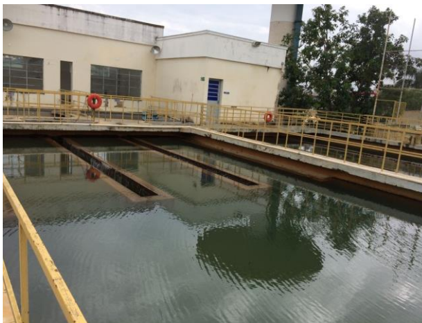
Figura 10 - Decantadores e Filtros
