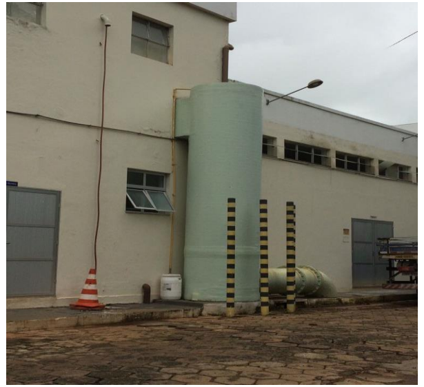
Figura 5 - Chegada da água bruta na ETA
