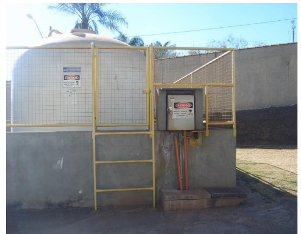
Figura 13 - Bomba dosadora de flúor
