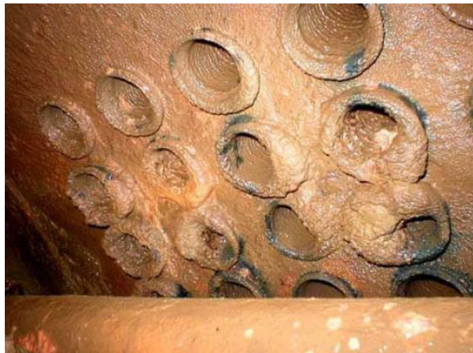
Figura 3 – Tubulão superior de caldeira com elevada quantidade de lama de origem argilosa
