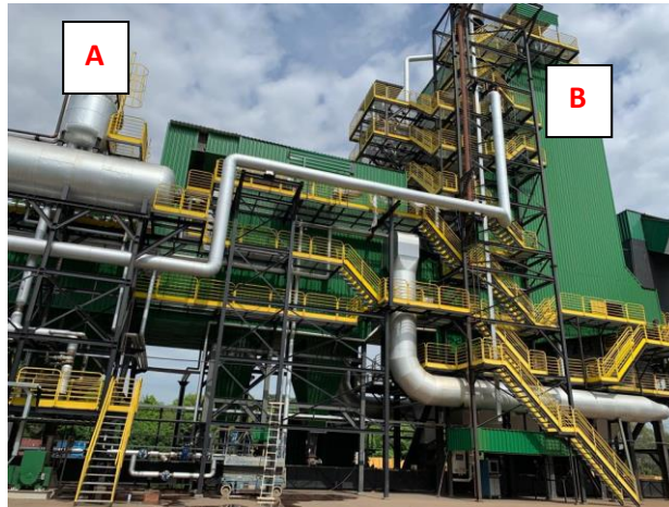
Fotografia 1 - Vista lateral da caldeira
