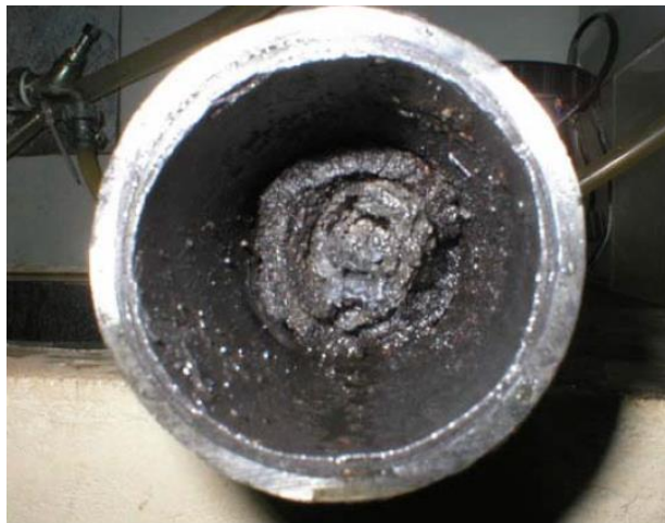
Figura 12 – Tubo de superaquecedor completamente destruído por sais originados de arraste
