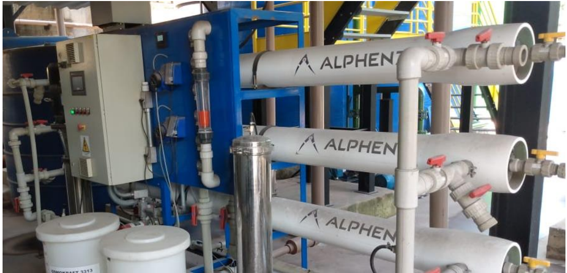
Fotografia 4 – Pré-tratamento com Osmose Reversa
