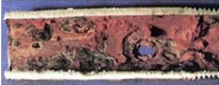
Figura 10 – Linha do retorno de condensado que sofreu processo de corrosão
