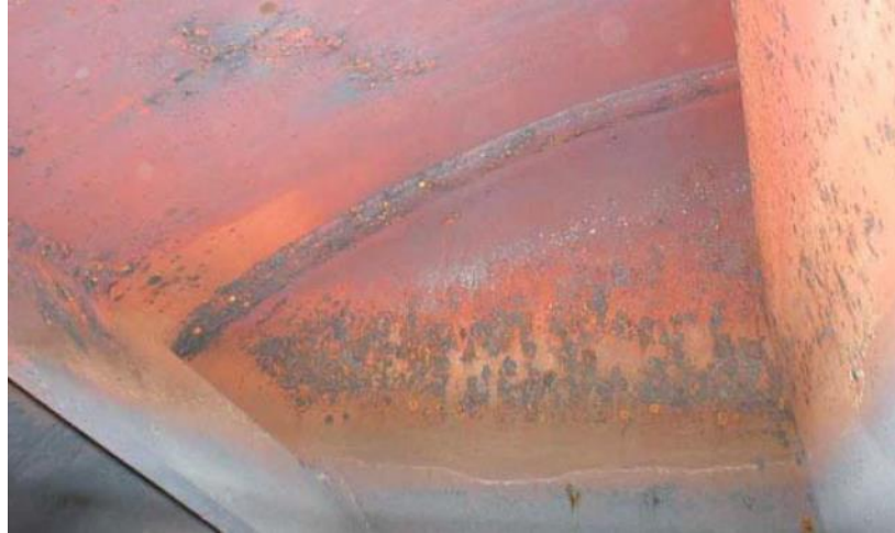
Figura 7 – Carcaça de uma caldeira com pontos de corrosão localizada (Pites)
