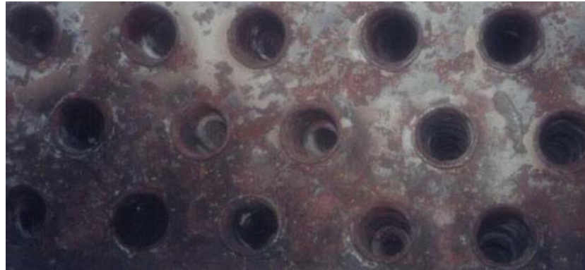
Figura 6 – Presença de incrustações no espelho e no interior dos tubos de uma caldeira aquatubular
