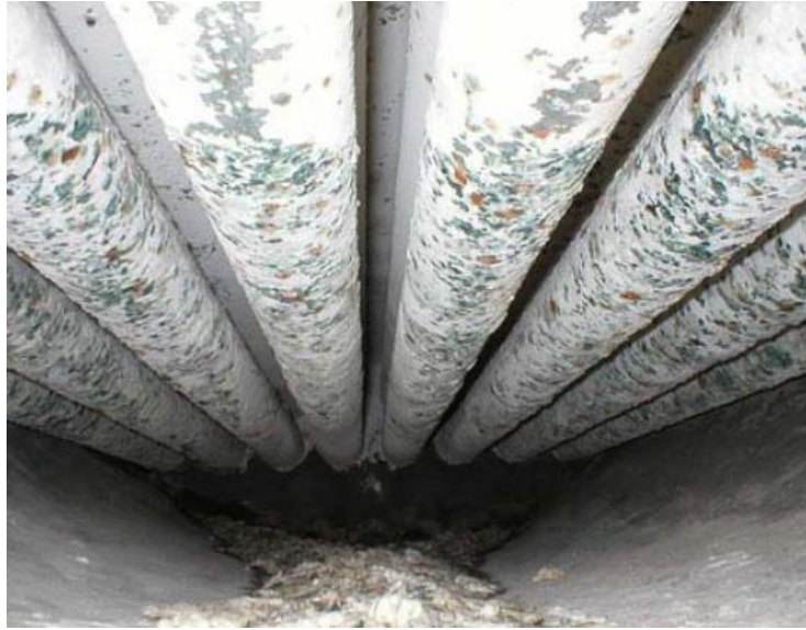
Figura 4 - Parte inferior de uma caldeira fogotubular com tubos incrustados por sais de dureza, com lama e depósitos no fundo
