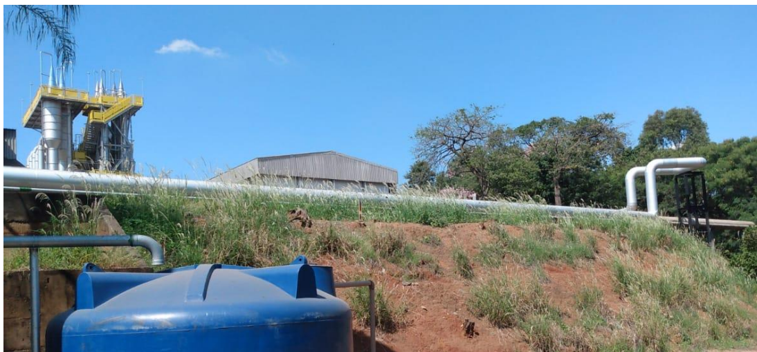
Fotografia 3 – Tubulação de vapor
