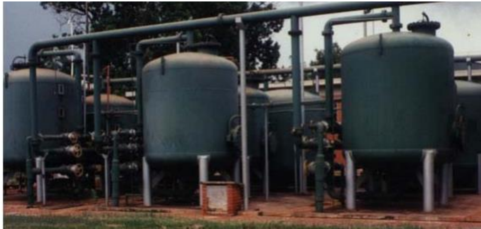
Figura 15 – Conjunto de vasos de um sistema de desmineralização
