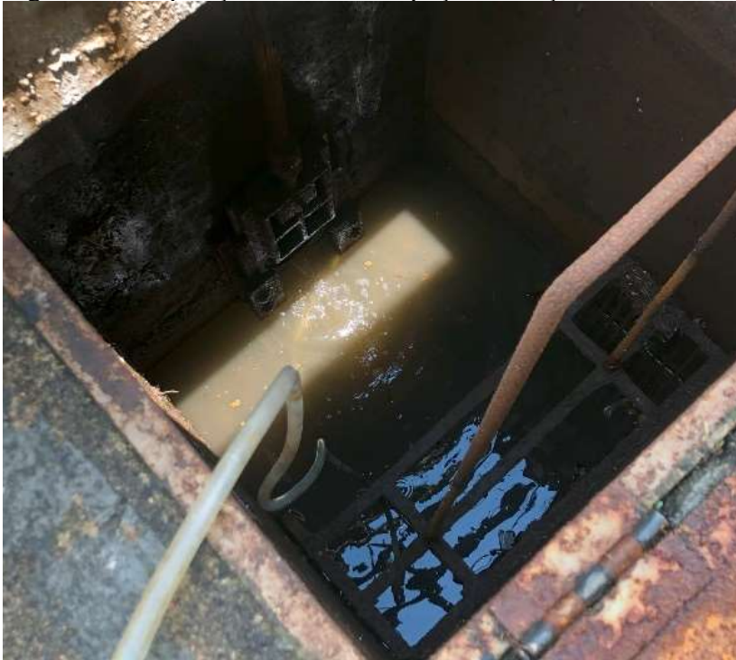
Figura 7 – Disposição da sonda no poço de sucção da elevatória
