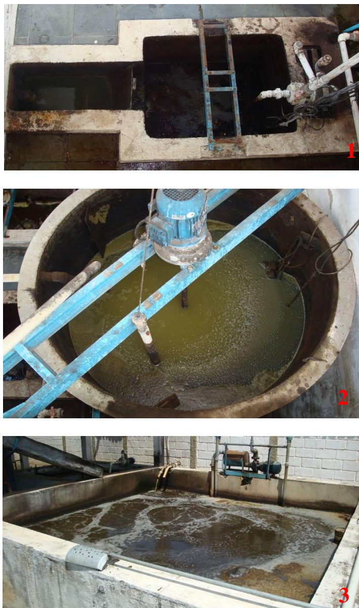
Figura 2- Etapas do tratamento na ETE da indústria onde foram coletadas as amostras de efluente bruto (1), efluente tratado quimicamente (2) e efluente tratado biologicamente (3).
